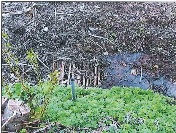
Figur 20 Rostigt galler vid utloppet Ravinen 2, (Ingår ej i detta uppdrag).
