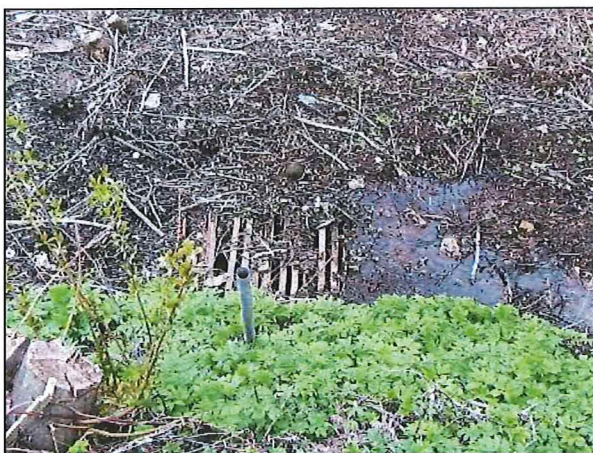
Figur 20 Rostigt galler vid utloppet Ravinen 2, (Ingår ej i detta uppdrag).
